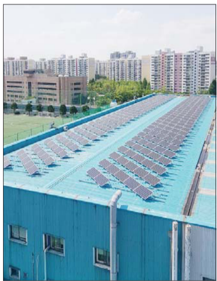
태양광 발전소 전경.
