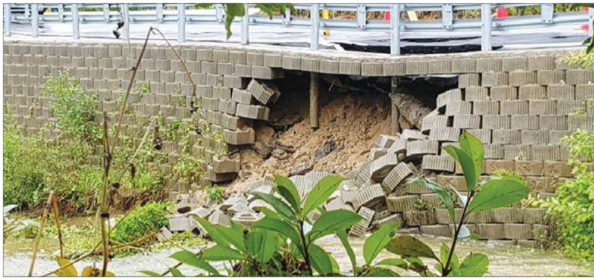
광주 북구 장등동 장등천 장등1교 옆 옹벽이 지난달 28일 내린 장맛비로 높이 3m, 폭 2.5m 정도 무너져 내렸다. 광주시는 무너져내린 옹벽에 모래 가마니를 쌓아 물이 들어가지 못하도록 응급조치를 했다. /연합뉴스
