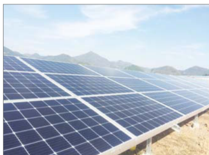
중국 후베이성 통산현에 설치된 한화큐셀 큐피크(Q.PEAK). /한화큐셀
