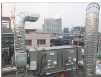
건물옥상에 설치된 악취방지시설(전기집진기). /서울시
