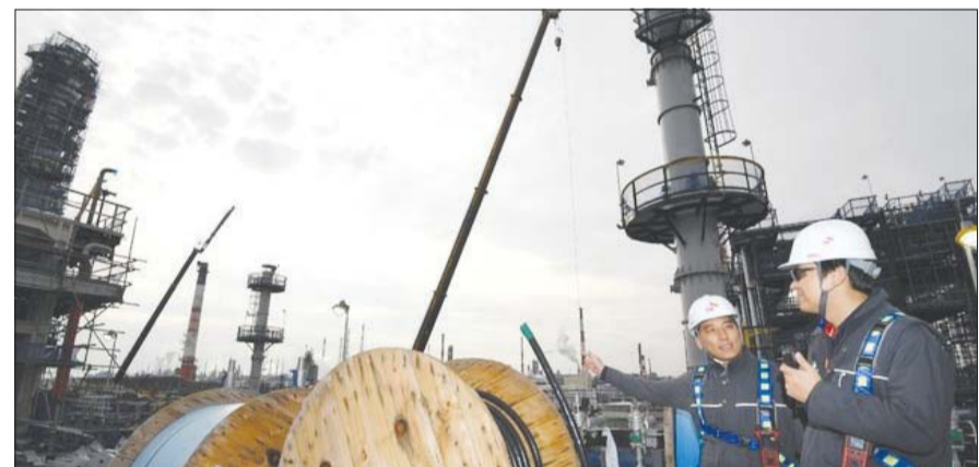
SK에너지가 IMO2020에 따른 저유황 수요에 대비하기 위해 약 1조원을 투자해 건설 중인 VRD S(감압잔사유탈환설비) 공사 현장. /뉴시스
