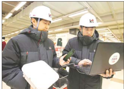
KT 네트워크부 직원들이 경기도 안양시 흥플러스 매장 내에 고성능 광중계기를 설치하고 5G 서비스 품질을 확인하고 있다. /KT
