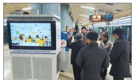
코닝-SNS의 지하철 승강장 미세먼지 저감 장치. (서울시)
