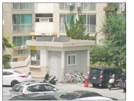
아파트 경비실에 설치된 태양광 패널. /서울시
