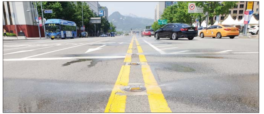
세종대로에 설치된 클린로드.
