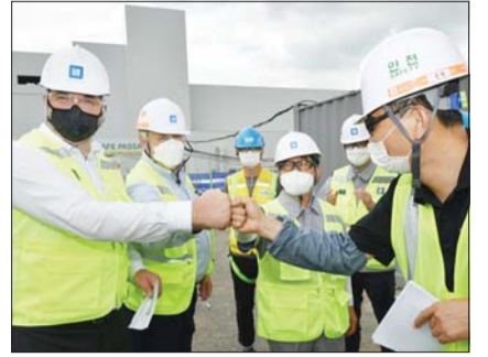
한국지엠의 카허 카젠 사장(왼쪽 첫번째)이 코로나19 상황속에서도 GM의 차세대 글로벌 신제품 생산을 위해 창원사업장에서 차질없이 신축되고 있는 도장공장 공사 현장을 방문해 직원과 인사를 나누고 있다.
