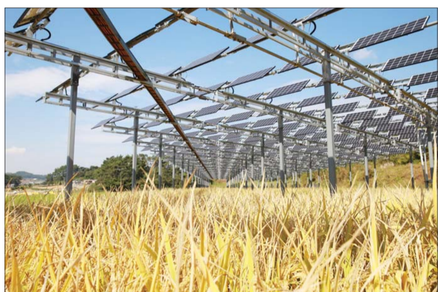
남해 관당마을 영농형 태양광 발전소.
