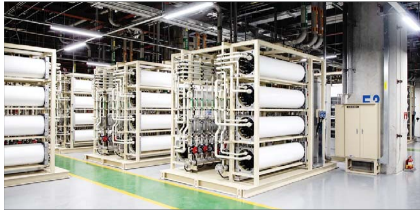
삼성전자 화성캠퍼스 그린센터에 있는 친환경 설비. /삼성전자
