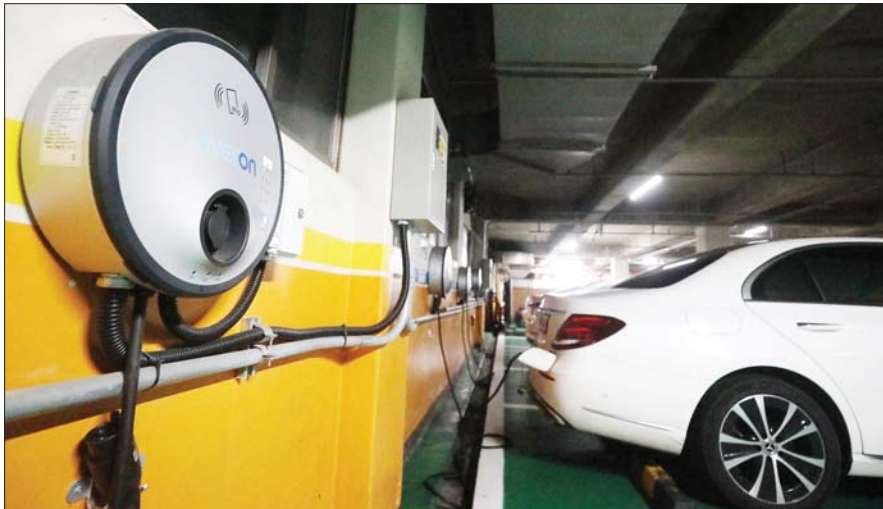
신축 건물 뿐 아니라 아파트를 포함한 기존 건물에 전기차충전소 의무설치비율이 적용된다. 20일 오전 서울 중구의 한 아파트 단지내 지하주차장에 전기차충전소가 설치돼 있다. /뉴스1
