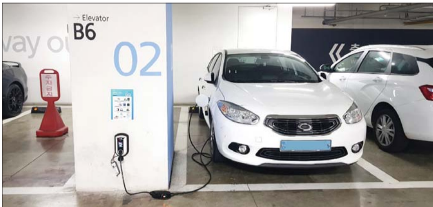
전기차 콘센트형 충전기 설치 사례.
