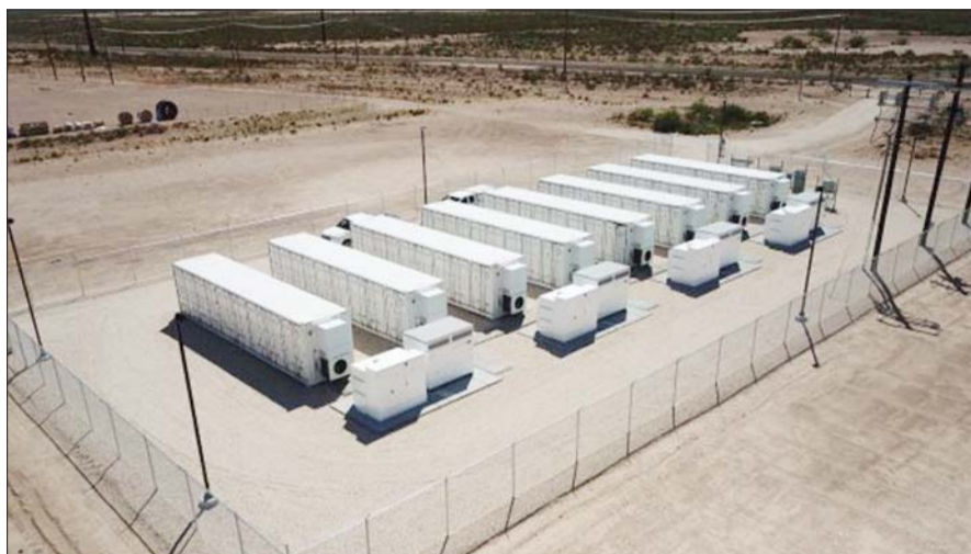
SK E&S가 인수한 KCE가 텍사스에 운영 중인 ESS 설비.
