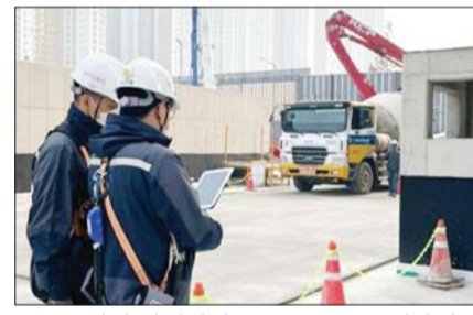
포스코건설 관리자가 송도 F19블록 현장에서 ‘레미콘 운송 정보관리 시스템’을 활용해 현장의 실시간 레미콘 타설현황을 모바일과 PC로 확인하고 있다. /포스코건설
