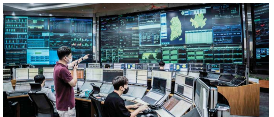
SKT와 SK오앤에스 구성원들이 SKT 분당사옥에 있는 네트워크 관리 센터에서 서비스를 운영하는 모습. /SKT
