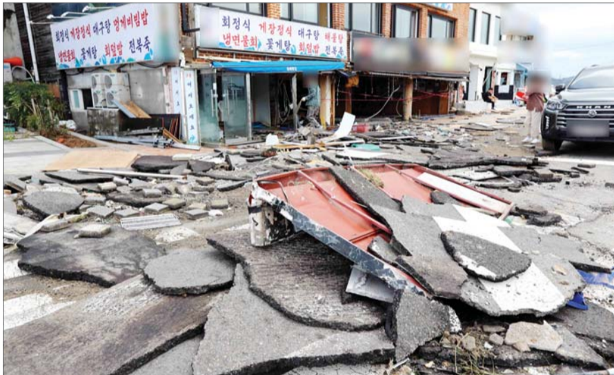
제11호 태풍 ‘힌남노’ 영향에서 벗어난 6일 부산 서구 송도해수욕장 인근 상가와 해안도로가 크게 파손됐다. /뉴시스
