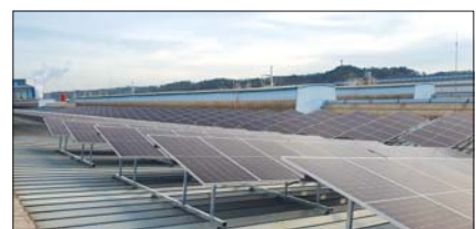
동국제강 포항공장 지붕에 설치된 태양광 자가발전 설비.
