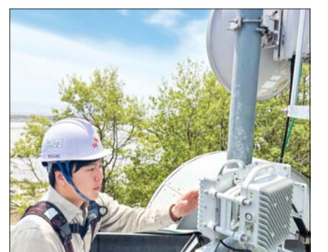
SKT 직원들이 도서 지역에 설치된 5G 마이크로웨이브 통신 장비를 점검하는 모습. /SKT
