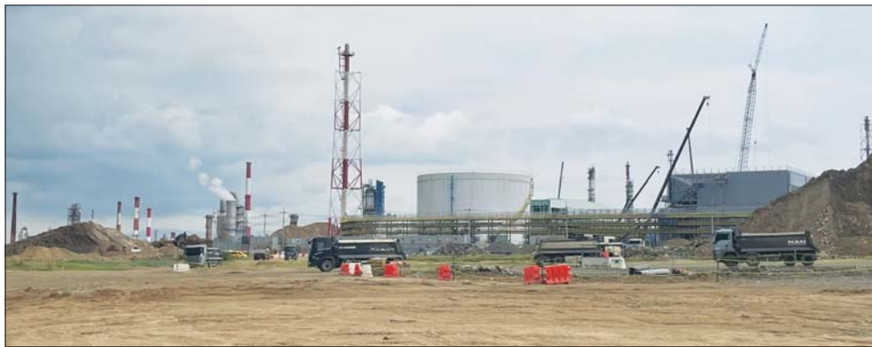
울산 남구에 위치한 SK 울산 콤플렉스(CLX·복합정유화학단지)페플라스틱 재활용 복합단지(ARC) 공사 현장. /허정윤 기자
