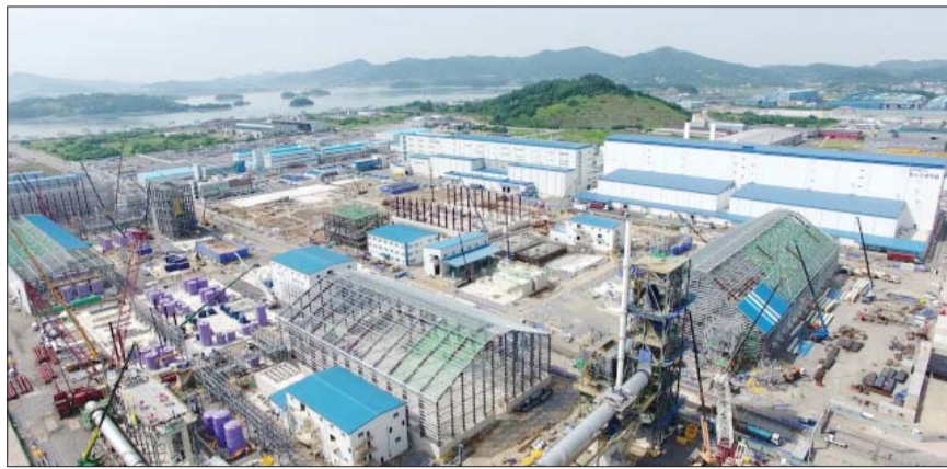
전라남도 울진산업단지에 위치한 포스코그룹의 이차전지 콤플렉스
