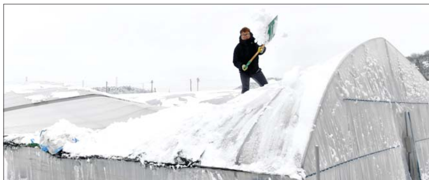
전남 담양군 고서면 한 딸기 재배 시설 하우스에서 농장주 임동만(39)씨가 폭설로 주저앉은 시설 하우스 위에 올라 눈을 치우고 있다. /뉴스
