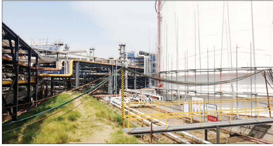
SK이노베이션 울산 공장 내 원유저장 지역.
