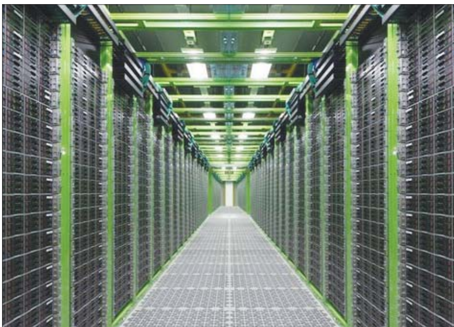
네이버의 춘천 데이터 센터 '각'의 전경. 서버로 빠르게 들어찬 데이터센터는 클라우드 서비스를 제공하는 핵심이다. /네이버
