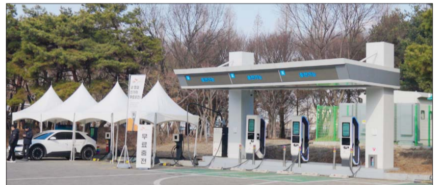
SK일렉트릭가 지난 설 연휴 충전난 해소를 위해 입장 거봉포도 휴게소(서울방향)에 설치한 임시 전기차 충전소 전경. /SK일렉트릭
