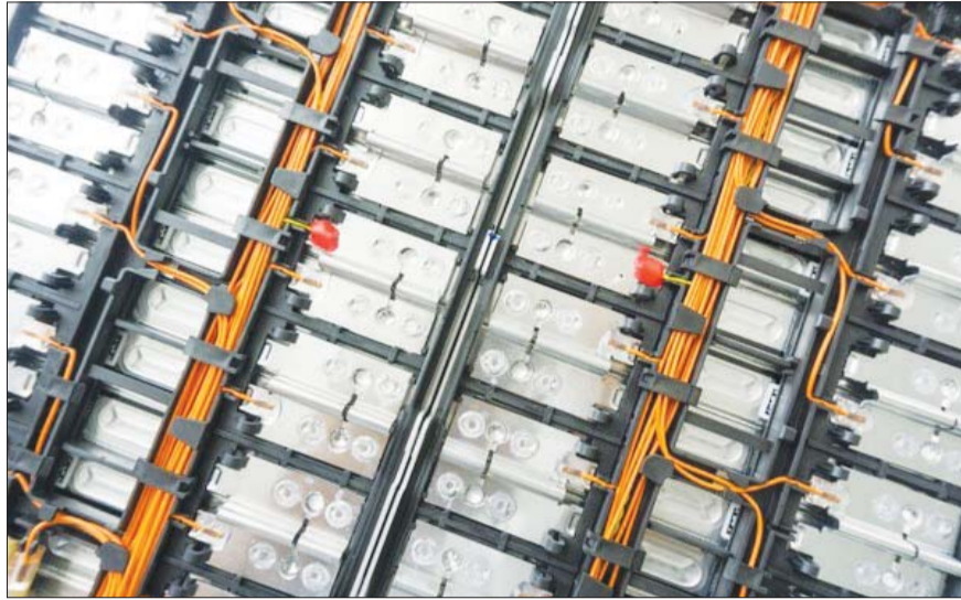
전기차에 장착되는 리튬 이온 배터리 팩. /사서터스톡
