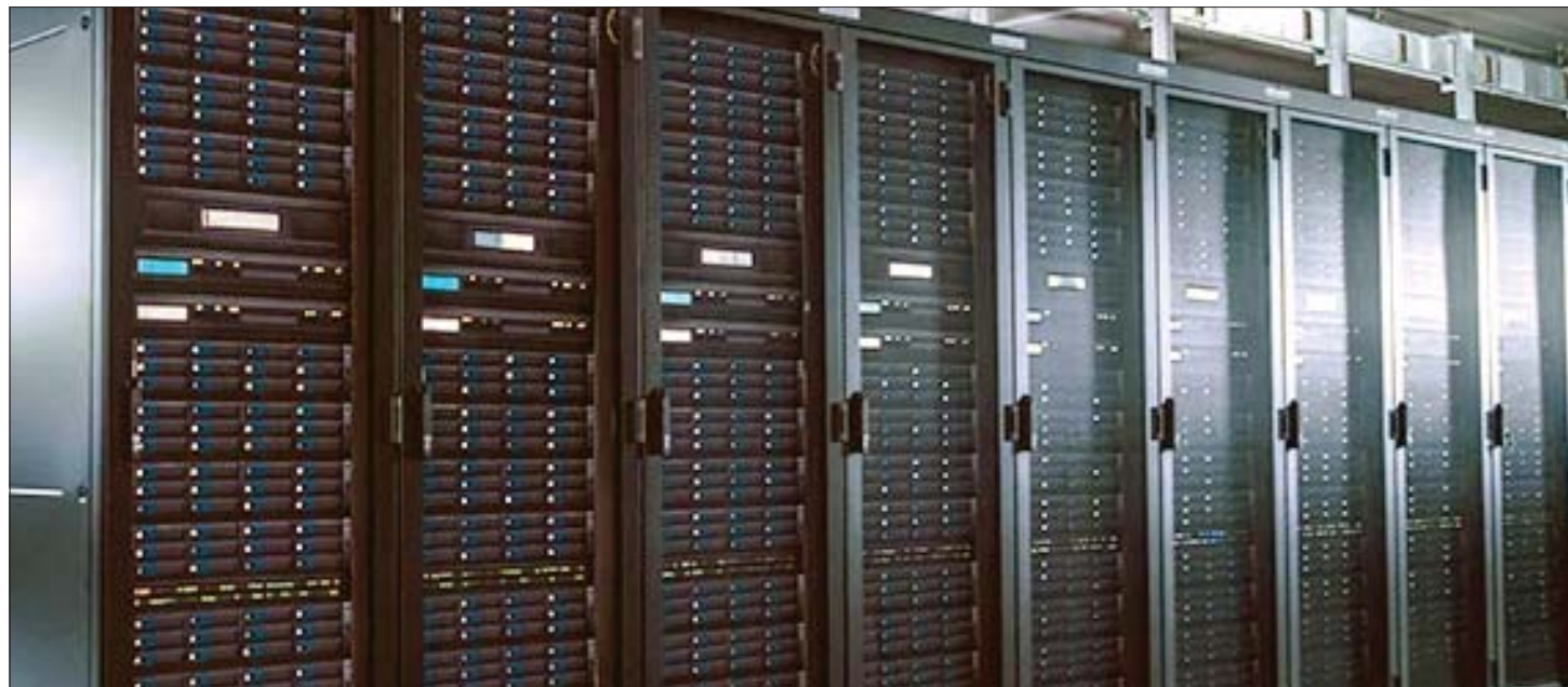
SK하이닉스 자회사 솔리다임의 데이터센터 전경. AI 기술의 급격한 발전으로 AI 데이터센터(IDC)의 전력 소모량이 기하급수적으로 늘고 있다. 업계에서는 전력 소모량을 줄일 수 있는 고효율 반도체 개발과 소형 원자력발전소(SMR) 등을 해결책으로 꼽고 있다. /솔리다임
