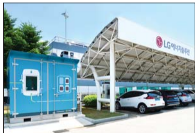
LG에너지솔루션 오창 에너지플랜트에 설치된 전기차 충전 ESS시스템. 전기차 사용후배터리를 재사용해 만들었다. /LG
