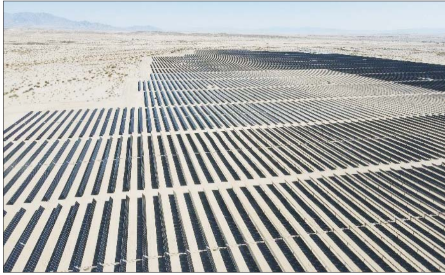
한화큐셀이 완공한 미국 캘리포니아 주 소재 태양광 발전소(50MW).
